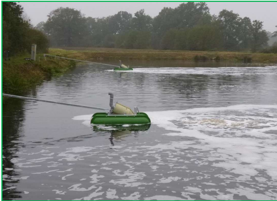
Abb. 2: Wendelbelüfter auf einem belüfteten Oxidationsbecken (Quelle: Fa. Fuchs)
